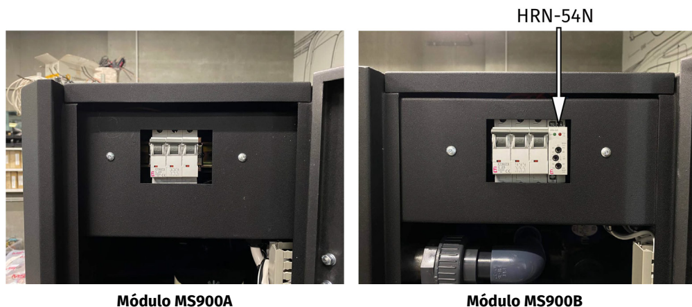
Figura 26. Encendido de los interruptores automáticos
