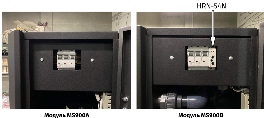
Рисунок 26. Включение автоматических выключателей
