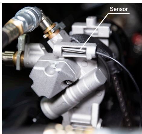
Figura 29. Posicionamiento del sensor de temperatura con contacto
